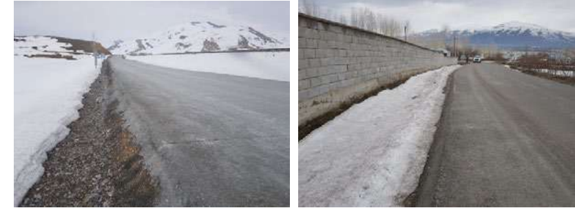
Şekil 11. Hendek imalatı yapılmamış yollar
