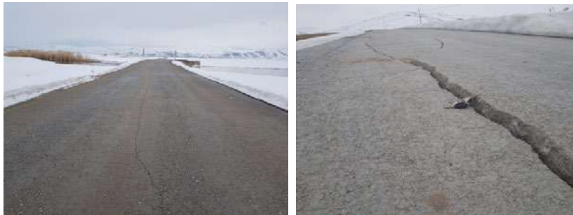
Şekil 10. 2021 yılında imalatı tamamlanan beton yollarda zemin problemlerinden kaynaklı çatlamlar
