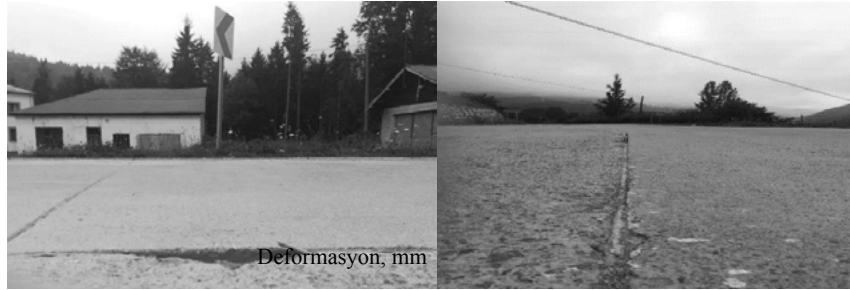
Şekil 3. Trabzon Tonya ilçesi Çayırıçi Mahallesi derzli donatısız beton yolda derzlerde oluşan deformasyonlar
